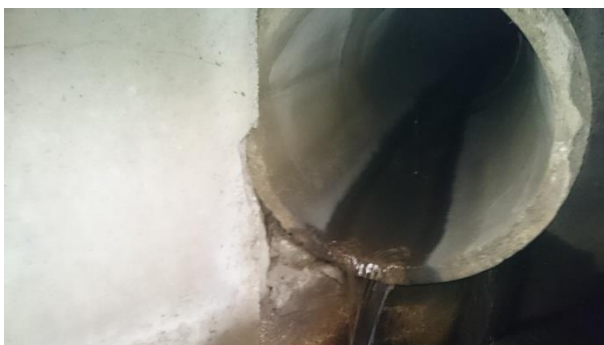
Foto 15041. Condotta proveniente da via Internati 1943-1945.
