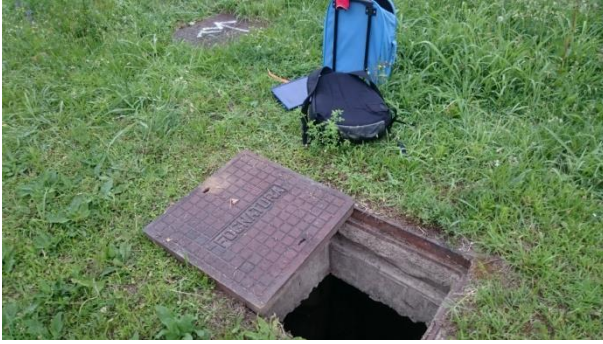
Foto 16022. Chiusino pozzetto scolmatore.
