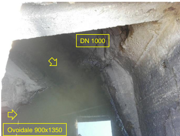
Foto 13022. Manufatto di sfioro lato nord.
