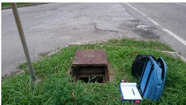
Foto 16030. Chiusino pozzetto acque meteoriche lungo via Cendon
