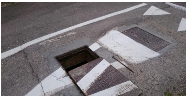
Foto 16037. Chiusini pozzetto impianto di sollevamento.
