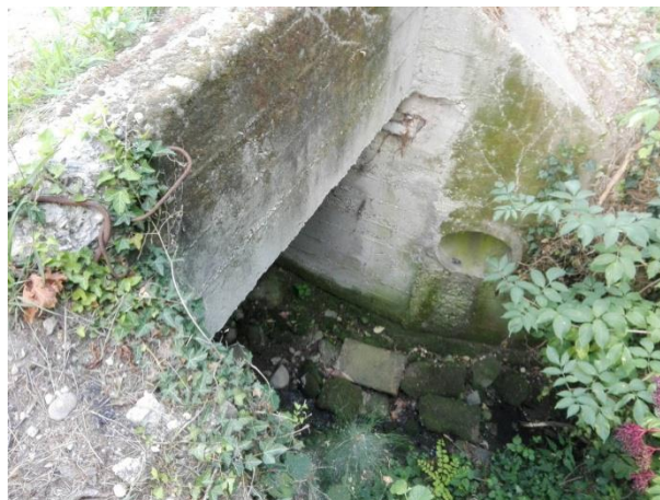
Foto 11022. Sbocco attraversamento di via Sant'Elena.
