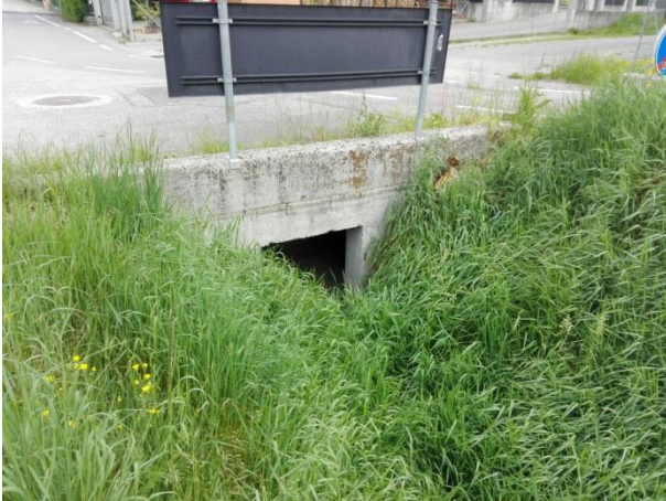
Foto 08019. Uscita del manufatto regolatore verso il fosso di via Cendon.
