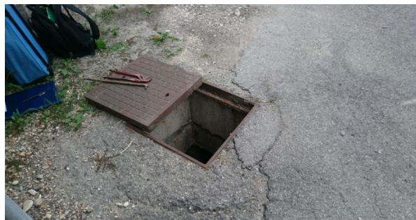
Foto 16042. Chiusino pozzetto di sfiro.
