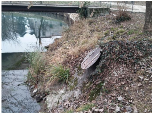
Foto 02083. Particolare dispositivo Clapet.
