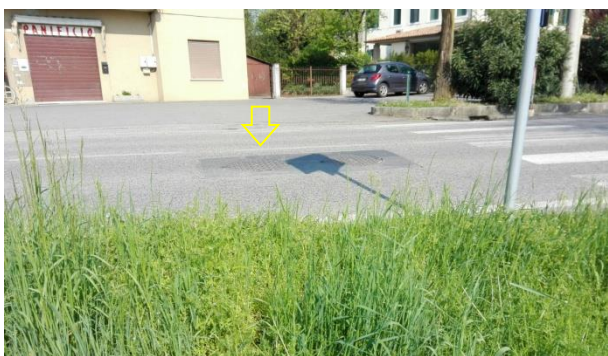
Foto 05200. Chiusino pozzetto di sfioro.
