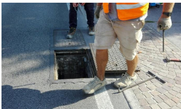
Foto 13208. Chiusini manufatto di sfioro.
