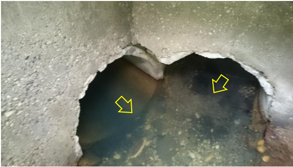
Foto 16025. Ingresso acque meteoriche via Cendon da Sud e area commerciale da Est.
