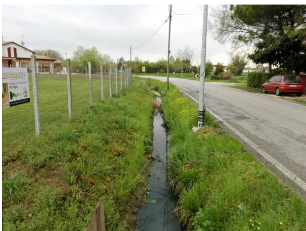
Foto 05111. Ristagno in via Pantiera lato est verso nord.
