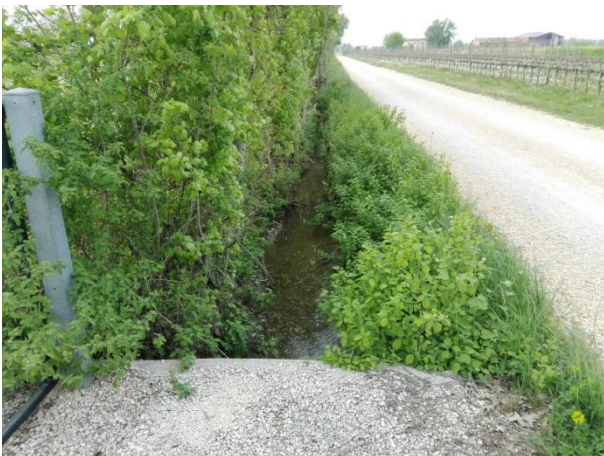
Foto 08311. Ristagno fosso lato ovest di via Claudia Augusta nel tratto sterrato a monte dell'incrocio con via Malviste
