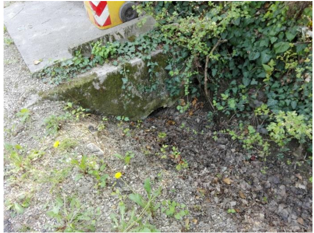
Foto 04234. Condotta ostruita via Avogadri.
