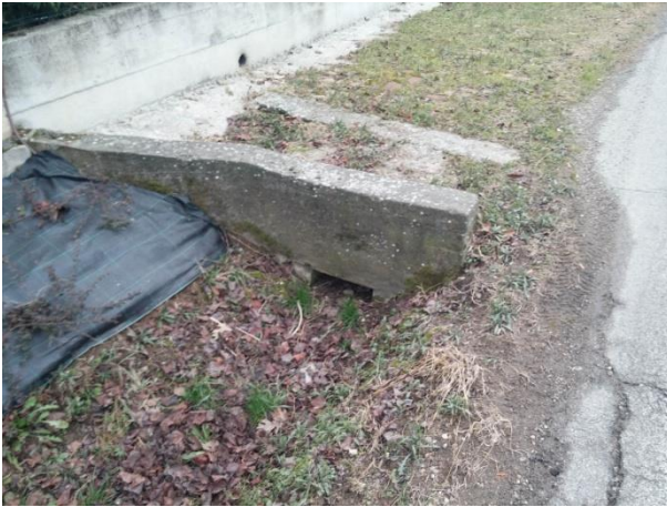
Foto 02061. Condotta fosso di via Creta.
