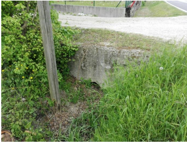
Foto 08212. Condotta parzialmente ostruita a monte dell'attraversamento di via Pozzetto
