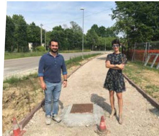
Nella foto: l'Assessore ai Lavori Pubblici Andrea Scomparin ed il Sindaco Rossella Cendron in visita al cantiere.
